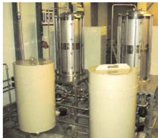
Die Membran-Anlage ist kompakt aufgebaut
