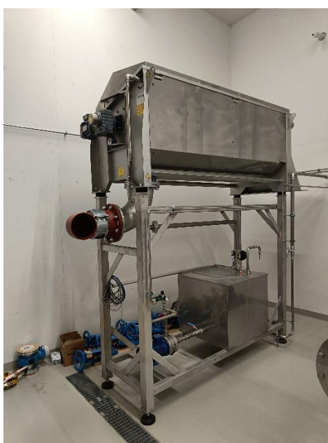
Gesamtbild der Anlage
