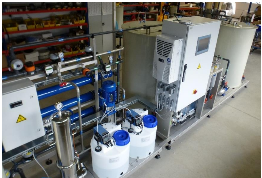
Gesamtbild der Anlage
