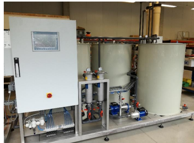
Anblick der Anlage vor der Auslieferung
