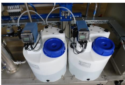
CIP-Station für chemische Reinigung
