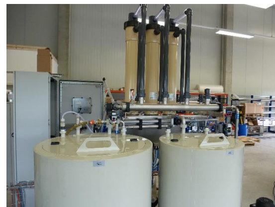
Anlage vor der Auslieferung
