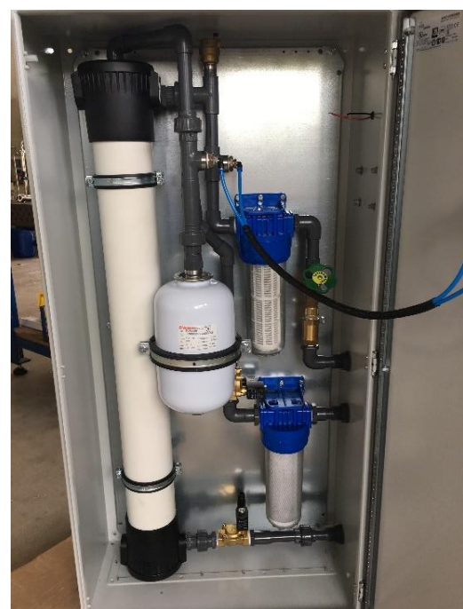
Anblick der Anlage
