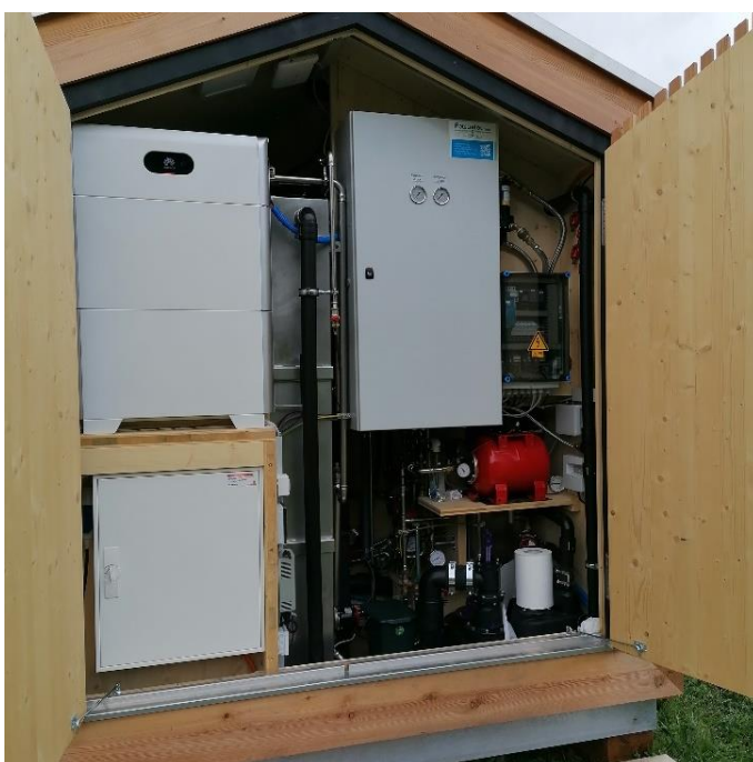
Wandmontage im Technikraum
