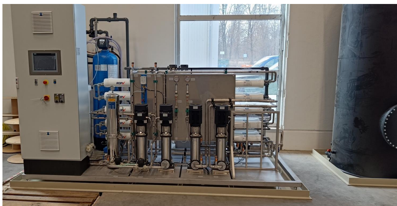
Gesamtbild der Anlage
