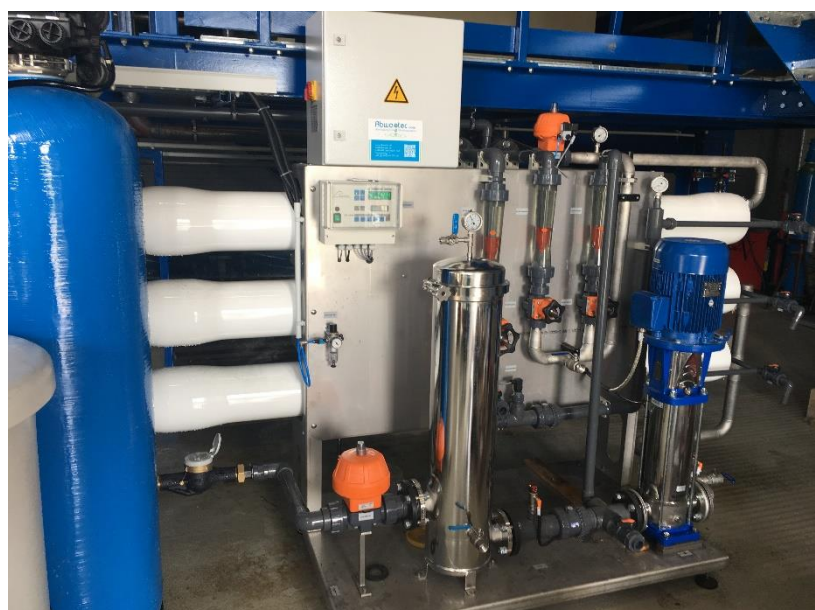
Gesamtbild der Anlage
