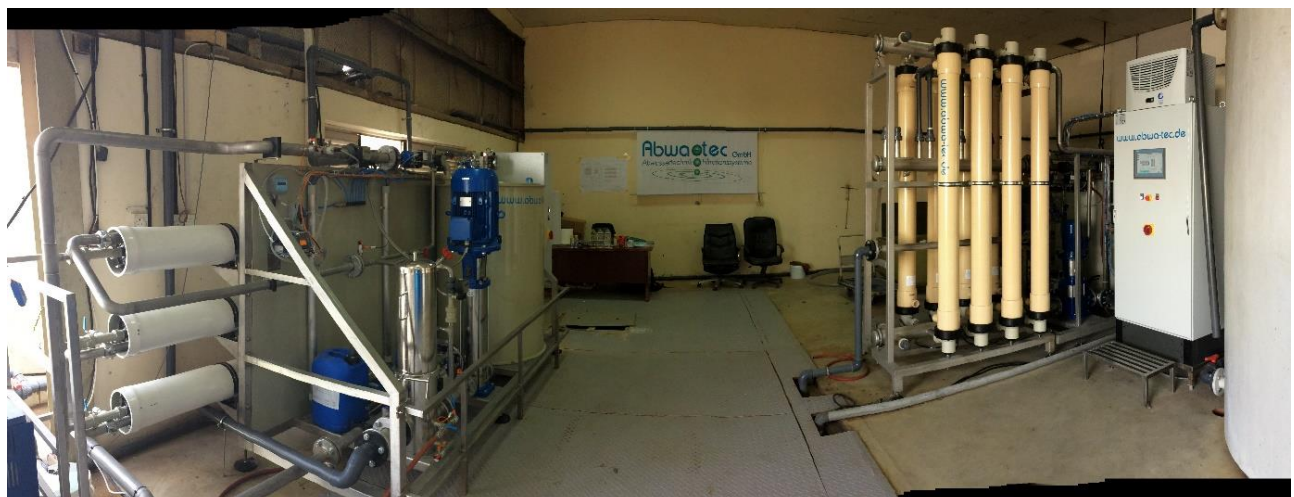
Gesamtbild der Anlage – Umkehrosmose (links), Ultrafiltration (rechts)
