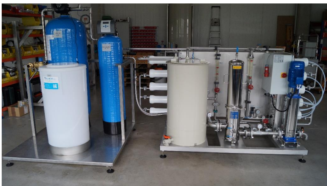
Gesamtbild der Anlage
