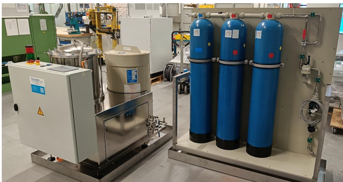
Gesamtbild der Anlage
