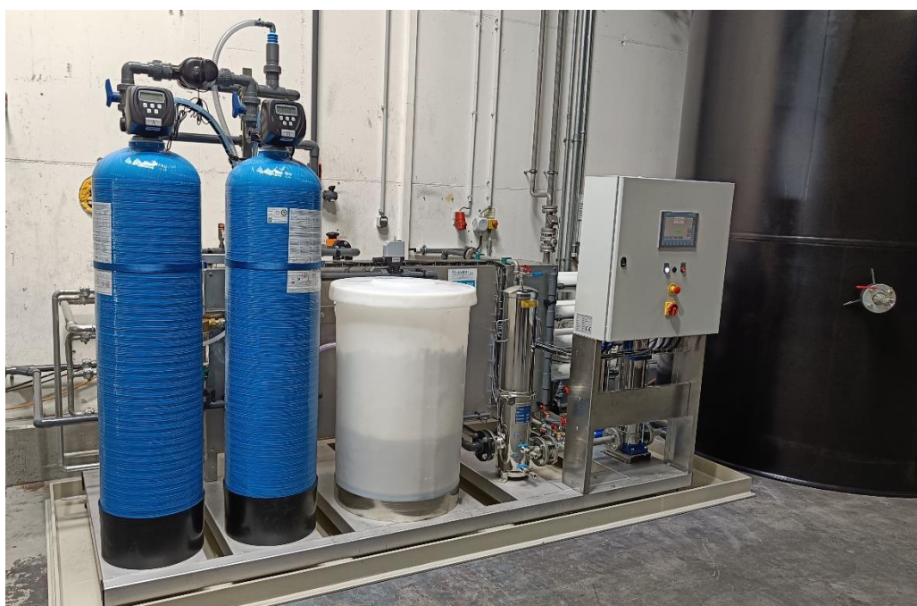
Gesamtbild der Anlage
