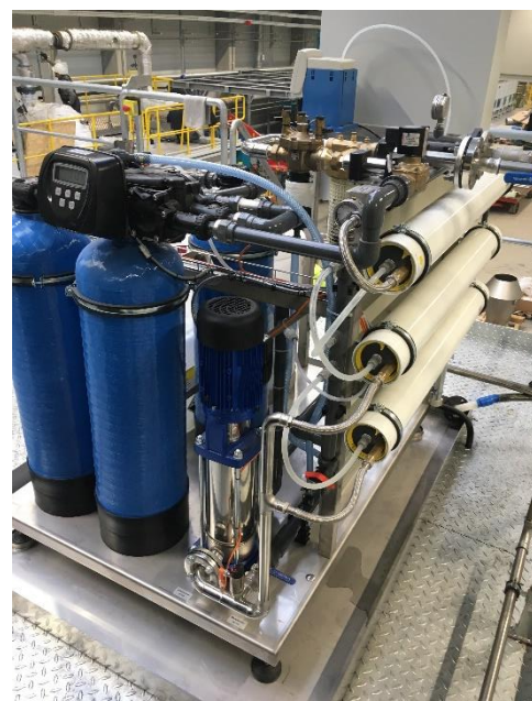
Gesamtbild der Anlage
