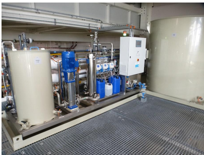
Gesamtbild der Anlage
