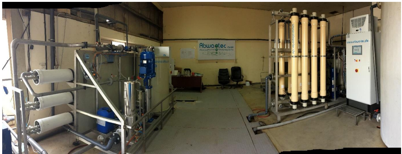
Gesamtbild der Anlage – Umkehrosmose (links), Ultrafiltration (rechts)
