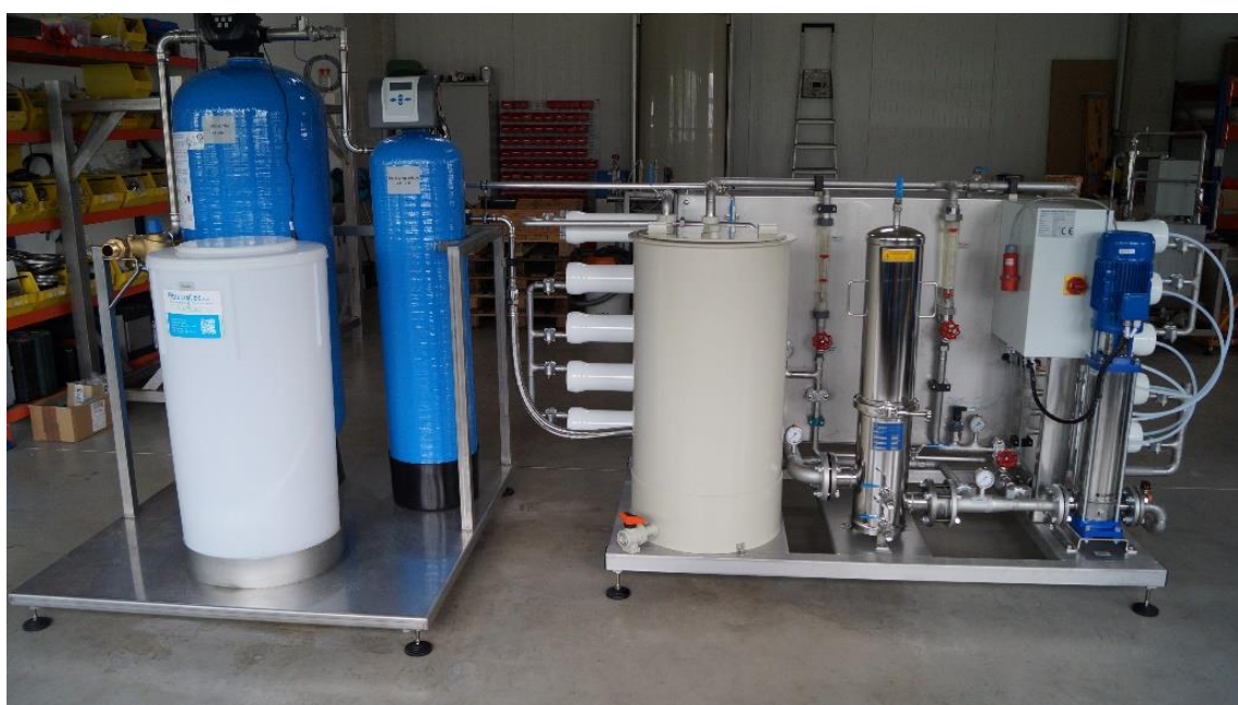
Gesamtbild der Anlage
