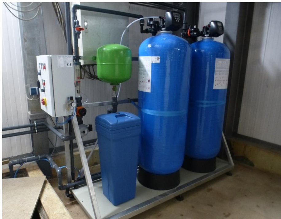
Gesamtbild der Anlage, Entmanganisierung/Enteisenung
