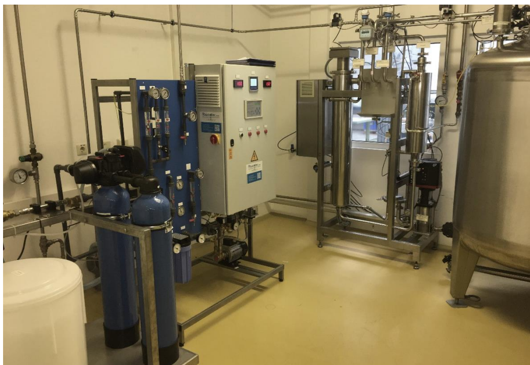
Gesamtbild der Anlage
