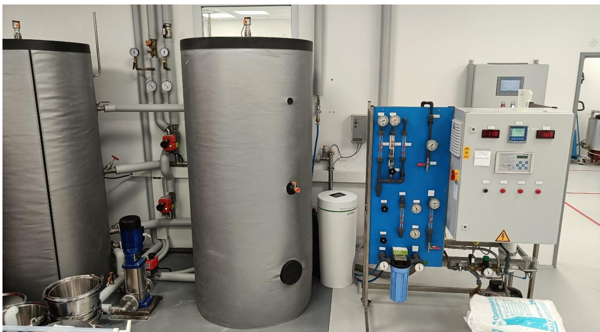
Gesamtbild der Anlage
