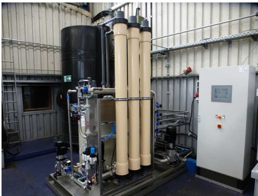
Gesamtbild der Anlage
