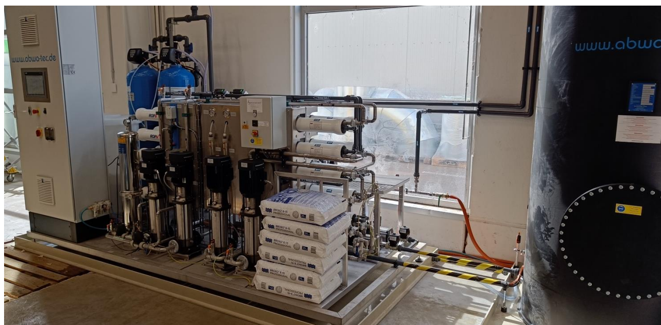
Gesamtbild der Anlage
